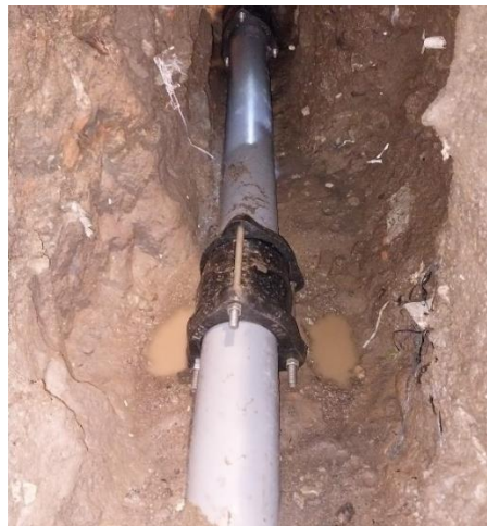
Gambar 4. 15 Pipa Jaringan Pelayanan PDAM Unit Depok
