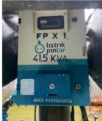
Gambar 4. 10 Sumber Listrik Utama PDAM Unit Depok
