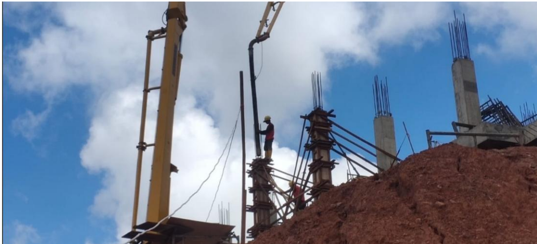
Gambar 1.6 Pekerja Tidak Memakai Body Harness
