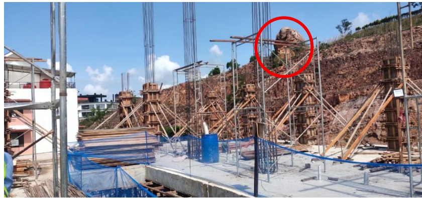
Gambar 1.4 Kondisi Lereng Sisi Belakang Proyek
