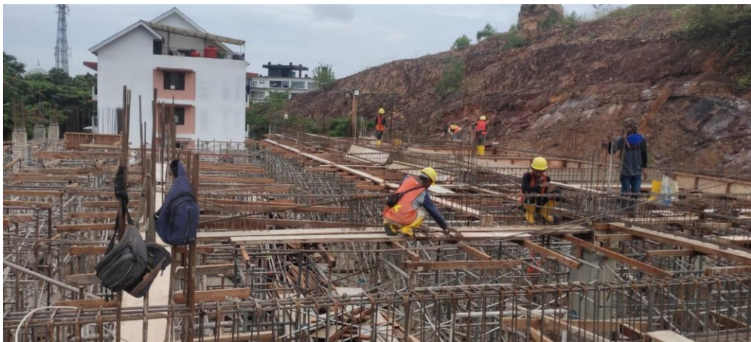
Gambar 1.7 Terdapat Pekerja Tidak Memakai APD
