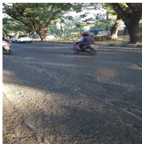
Gambar 4.5. Kerusakan Retak Buaya Lapisan Aspal dan Alur
