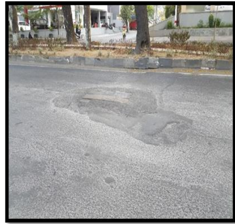
Gambar 4.13. Kerusakan Tambalan Jalan
