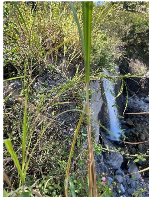
Gambar 14 Kerusakan Subdam BE-D4
