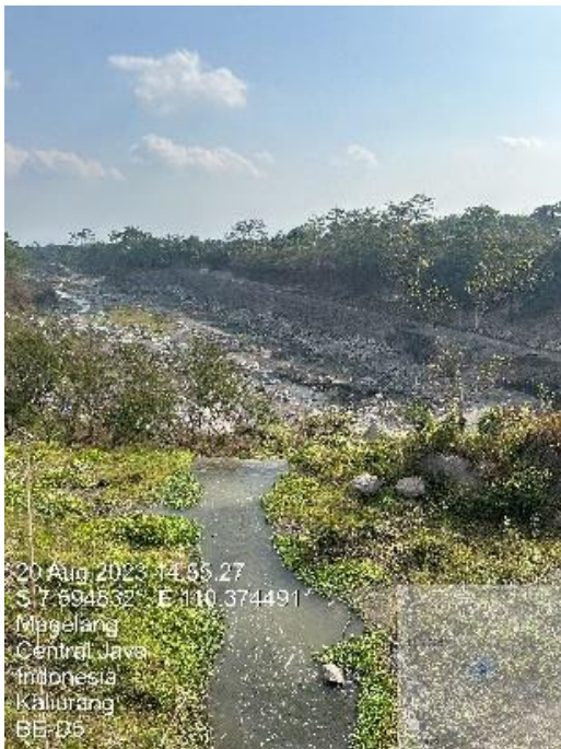
Gambar 13 Hilir Bangunan BE-D4 yang Berpotensi Longsor
