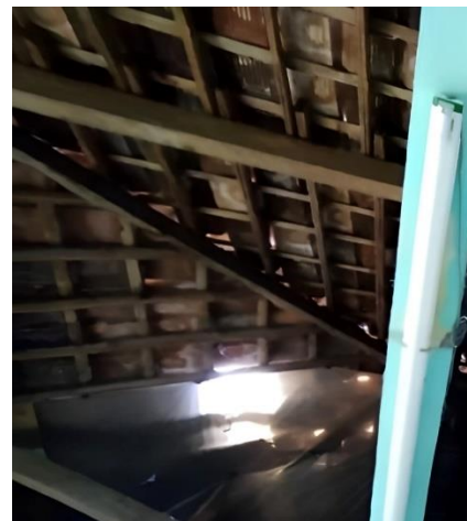
Gambar 12. Penutup Atap dibiarkan Rusak
