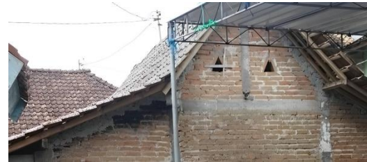
Gambar 11. Hasil Renovasi Struktur Ampig Tidak Sesuai Standar
