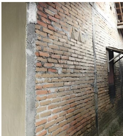
Gambar 10. Hasil Renovasi Struktur Kolom Tidak Sesuai Standar
