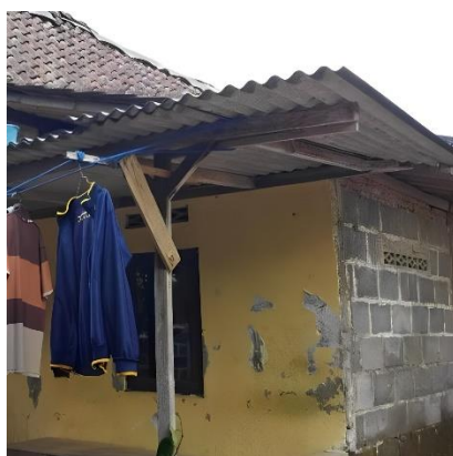
Gambar 8. Bangunan Tanpa Struktur Ringbalok
