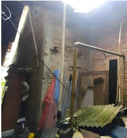
Gambar 9. Kondisi Dinding yang Berlubang dan Bergelombang
