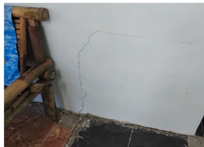
Gambar 20. Keretakan Dinding Akibat Tanah Kurang Stabil
