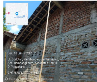
Gambar 16. Rumah Tanpa Struktur Ringbalk Miring
