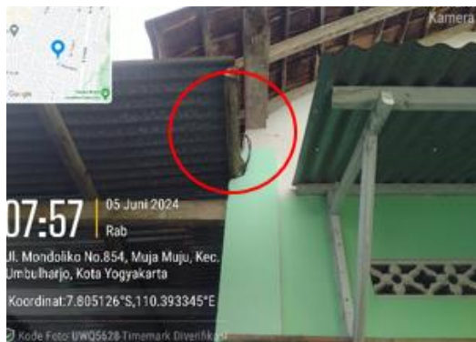
Gambar 18. Struktur Kolom yang Dirusak
