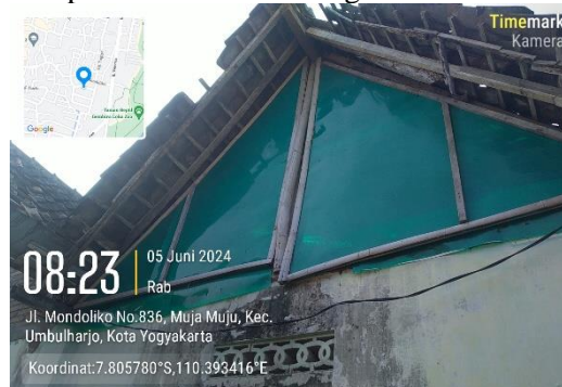
Gambar 17. Kuda-kuda Atap yang Tidak Sesuai.
