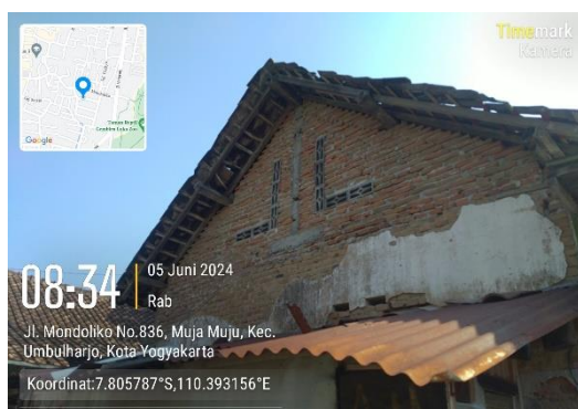
Gambar 15. Rumah Tanpa Balok Ring
