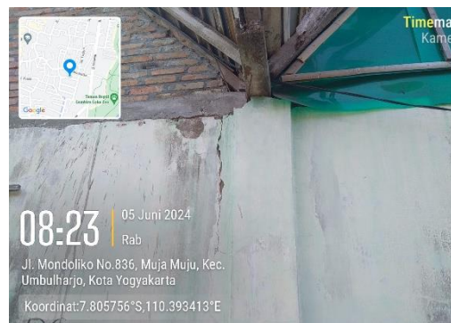
Gambar 16. Rumah dengan Balok Ring yang Tidak Menyeluruh.
