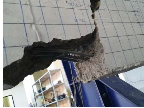
Gambar 10. Kondisi Tulangan Balok 6 (belum putus)
