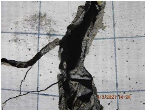
Gambar 15. Tampak CFRP dan rechan BVII
