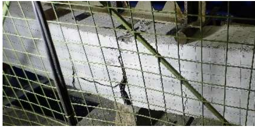
Gambar 14. Tampak retakan BVII
