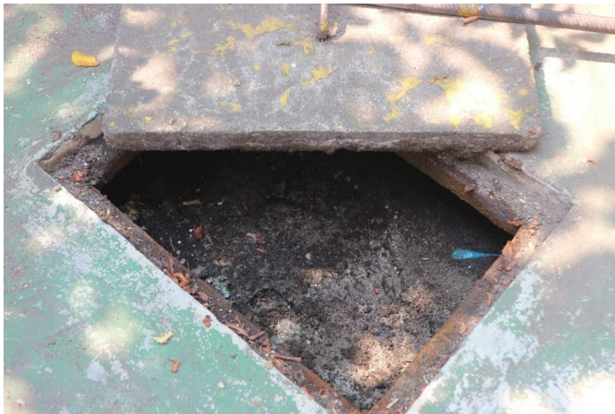
Gambar 4.20 Akumulasi Pasir dan Kerikil pada Unit IPAL
