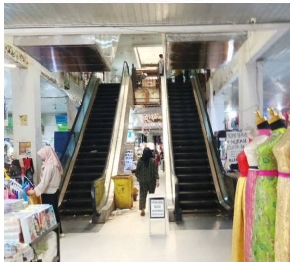
Gambar 42 Kondisi eskalator Pasar Sentral Kota Kendari Sumber: Dokumen Pribadi, 2024
