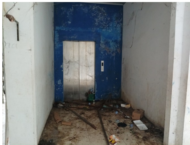
Gambar 40 Kondisi lift Pasar Sentral Kota Kendari Sumber: Dokumen Pribadi, 2024
