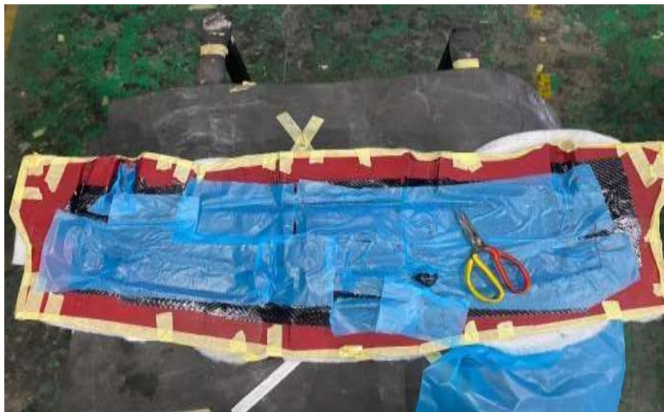
Gambar 3.4-3 Pemasangan Peel Play dan Flow Media
