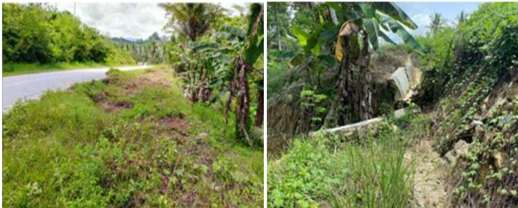
Gambar 4.2 Longsoran pada lereng jalan (sumber: PT. Plato Isoiki – PT. Iraya konsultan, KSO)
