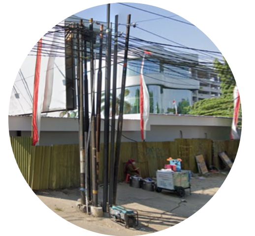
Kumpulan tiang listrik yang tidak rapi
