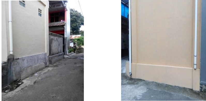
Gambar 5.4 Talang Air yang Mengalirkan Air Hujan Langsung ke Jalan yang Berada di Dusun Lodadi
