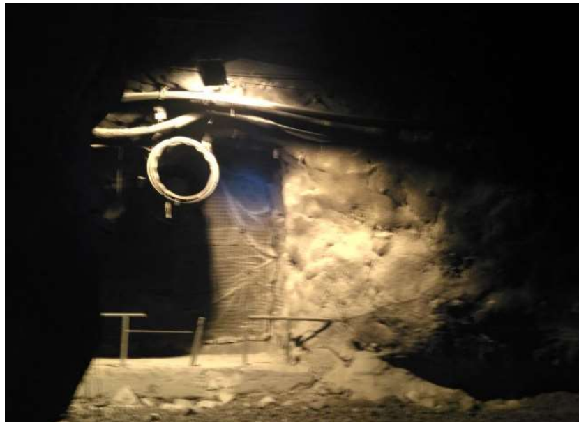
Gambar 4.12 Ducting Ventilasi di Tambang Z
