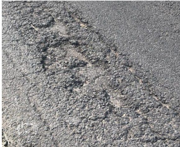
Gambar 5.12 Contoh Kerusakan pada STA 16+400
