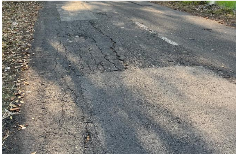
Gambar 5.16 Contoh Kerusakan pada STA 16+800
