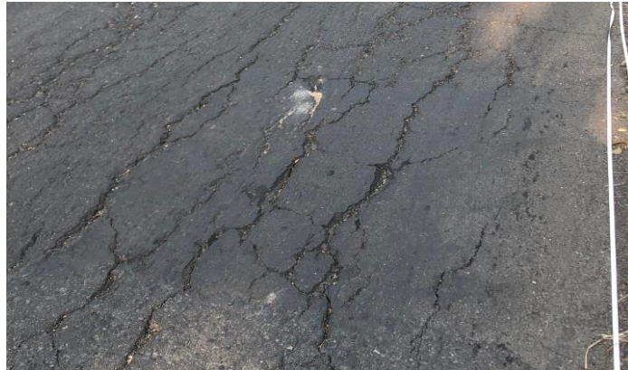
Gambar 5.18 Contoh Kerusakan pada STA 17+000
