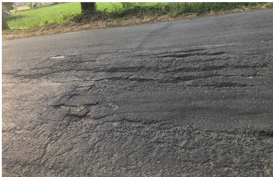
Gambar 1.1 Kerusakan Jalan Godean
