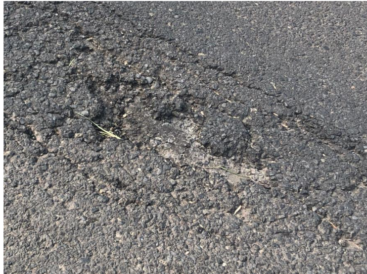
Gambar 5.15 Contoh Kerusakan pada STA 16+700
