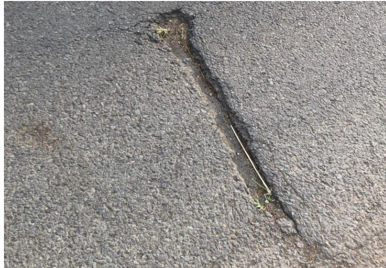
Gambar 5.10 Contoh Kerusakan pada STA 16+200
