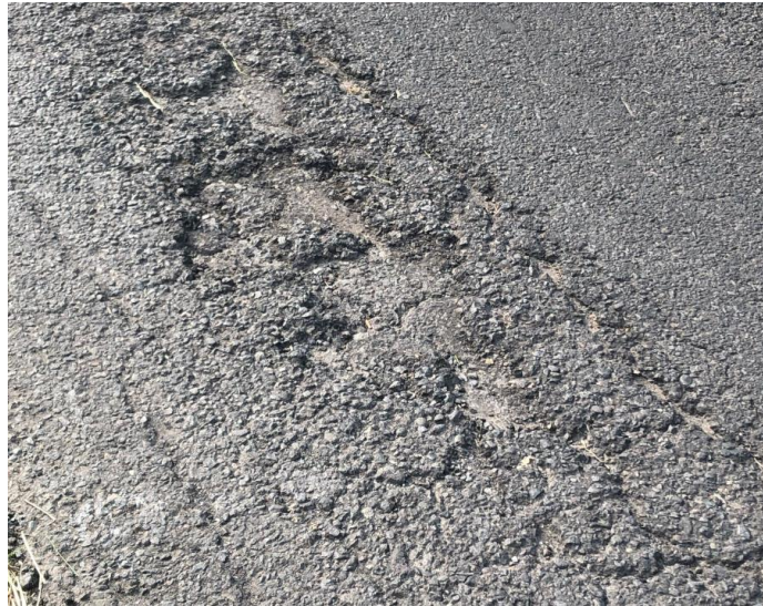
Gambar 5.17 Contoh Kerusakan pada STA 16+900
