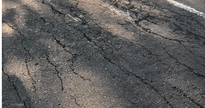
Gambar 5.11 Contoh Kerusakan pada STA 16+300
