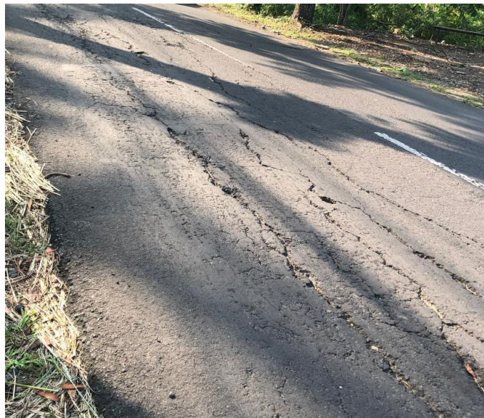
Gambar 5.13 Contoh Kerusakan pada STA 16+500
