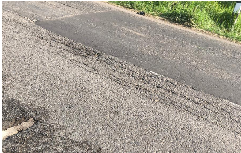
Gambar 5.14 Contoh Kerusakan pada STA 16+600
