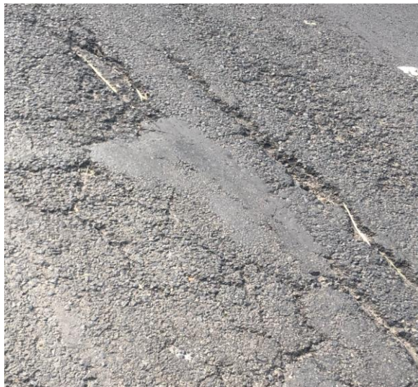
Gambar 5.9 Contoh Kerusakan pada STA 16+100
