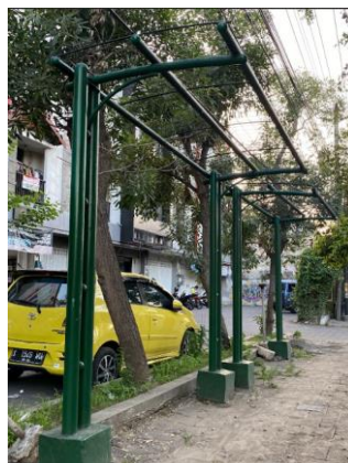
Gambar 6. Kondisi Peneduh Jalur 9
