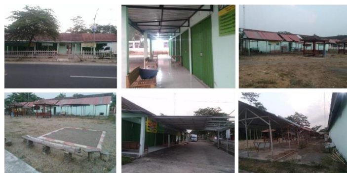
Gambar 6 Kondisi Bangunan Pasar Klithikan Gentan Sumber: Dokumentasi Pribadi, 2023
