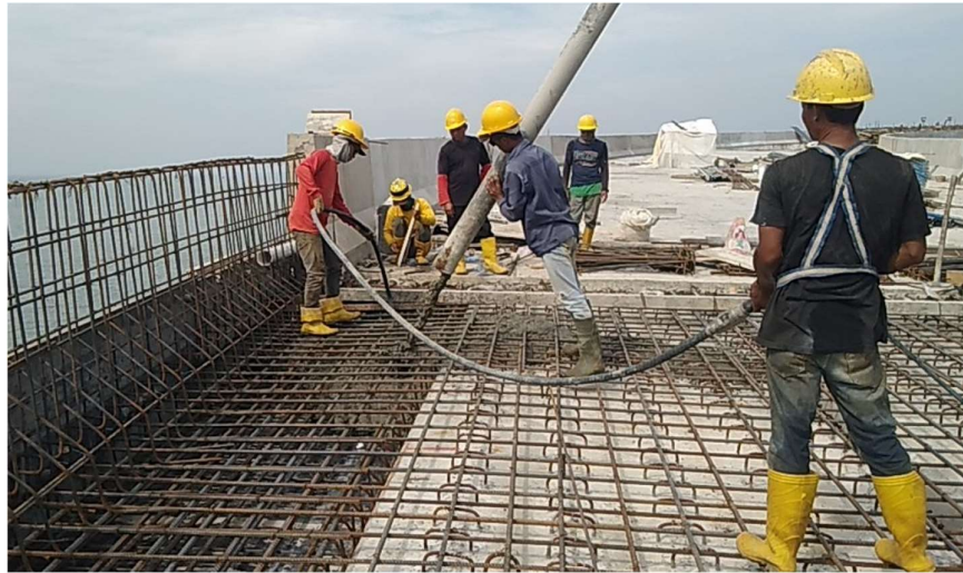
Gambar 5.34 Cor Antar Half Slab Bersamaan Dengan Lantai Jembatan (sumber: proyek pembangunan infrastruktur akses jalan jetty kit batang)
