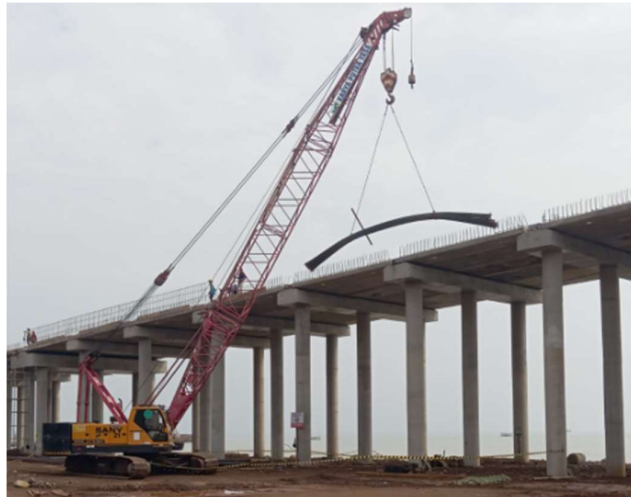
Gambar 5.28 Crawler Crane Sany Kapasitas 50 Ton (sumber: proyek pembangunan infrastruktur akses jalan jetty kit batang)
