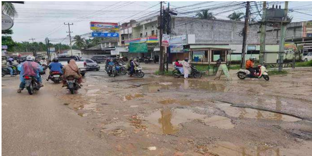
Gambar 1.2 Jalan Rusak di Pekanbaru
