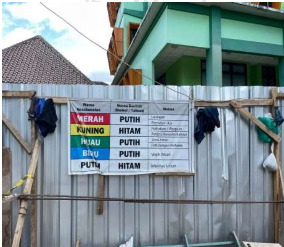
Gambar 5.7 Label Bahaya di Sekitar Proyek
