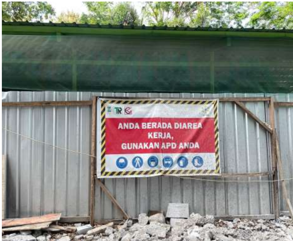
Gambar 5.6 Label Bahaya di Sekitar Proyek
