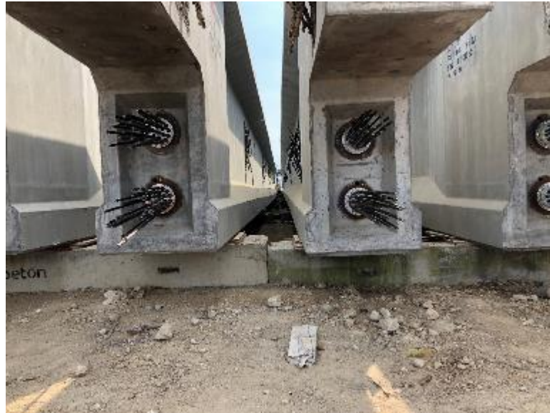
Gambar 5. 7 Terlihat terjadi penurunan pada concrete sleeper di sebelah kanan yang menopang balok girder yang telah selesai dilakukan pekerjaan stressing (sumber: Dokumentasi pribadi)
