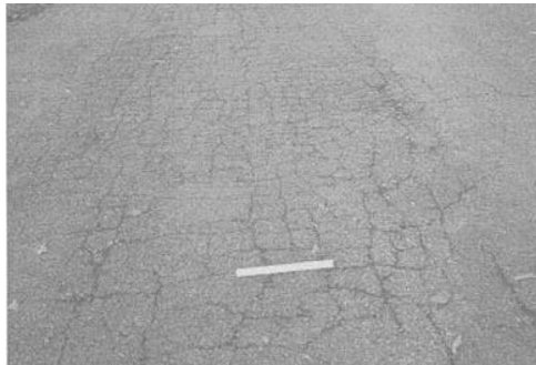
Gambar 3. 2 Gambar Kerusakan Alligator Cracking
