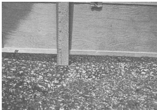
Gambar 3. 12 Contoh Kerusakan Rutting
