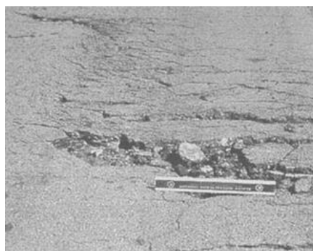
Gambar 3. 14 Contoh Kerusakan Slippage Cracking
