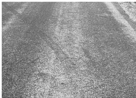
Gambar 3. 3 Contoh Kerusakan Bleeding
