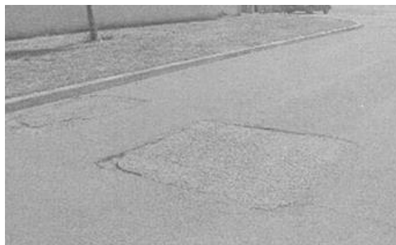
Gambar 3. 9 Contoh Kerusakan Patching
