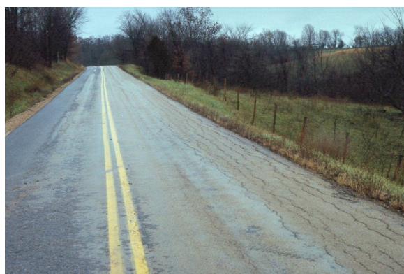
Gambar 2.5 Retak Lelah ( Fatigue Cracking )
