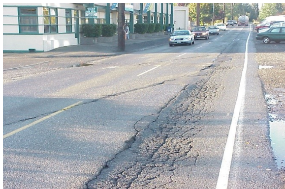
Gambar 2.6 Retak Alur ( Rutting )
