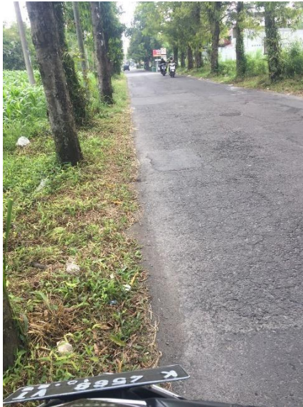
Gambar 4.10 Pengujian pada kondisi jalan yang rusak
