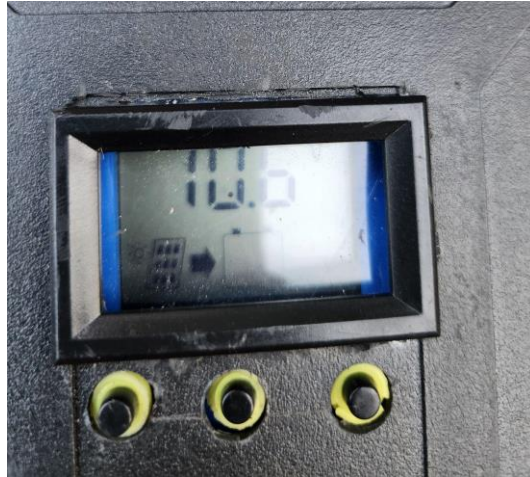
Gambar 5. 10 Kondisi baterai sebelum charging
