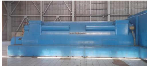
Gambar 5.5 Turbin pada Unit STG ( Steam Turbin Generator )
