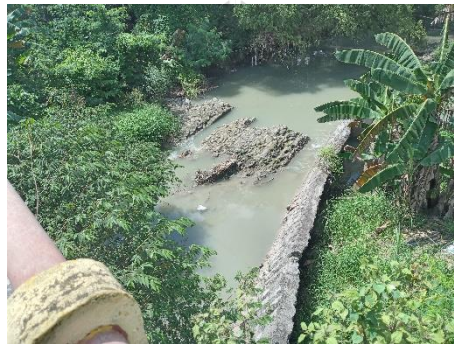
Gambar 4.4 Kondisi DPT Jembatan Pening Kloji
