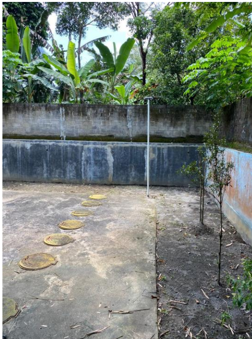
a.) Gambar Kondisi IPAL Komunal Harapan Asri
