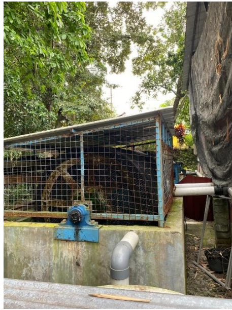
a.) Gambar Kondisi IPAL Komunal Mendiro
