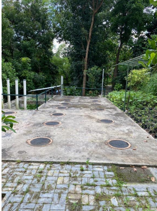
a.) Gambar Kondisi IPAL Komunal Mina Sehat
