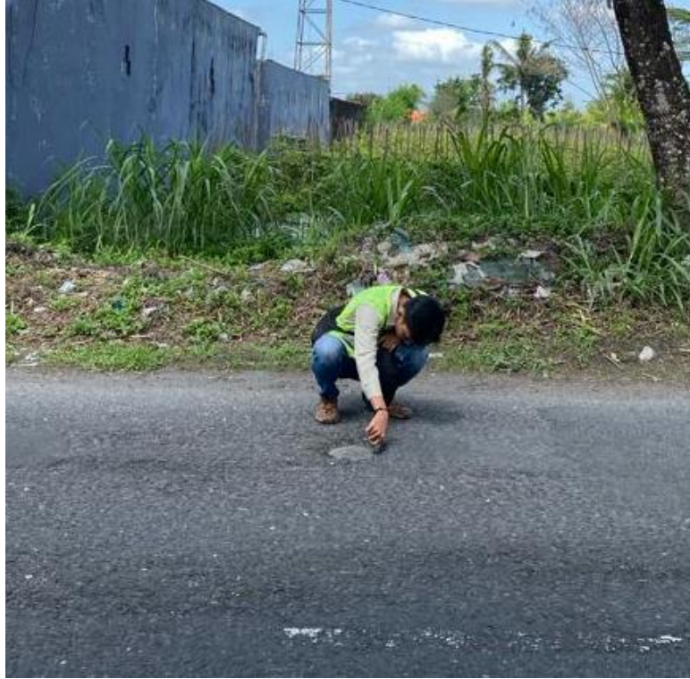
Gambar 1 Pengukuran Kerusakan Pothles
