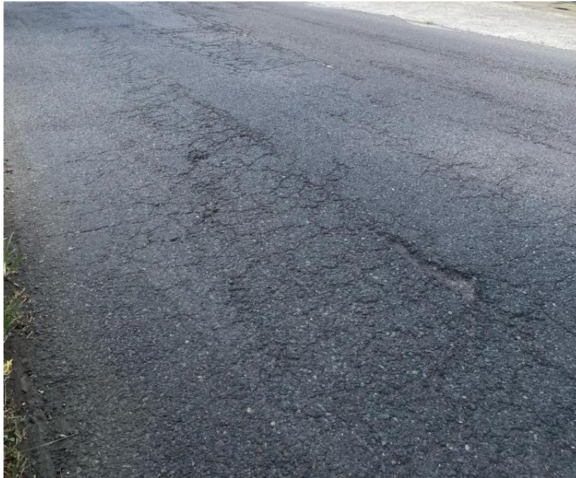
Gambar 5 Kerusakan Alligator Cracking
