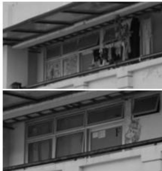
Gambar 21. Penutup pada Jendela Hunian
