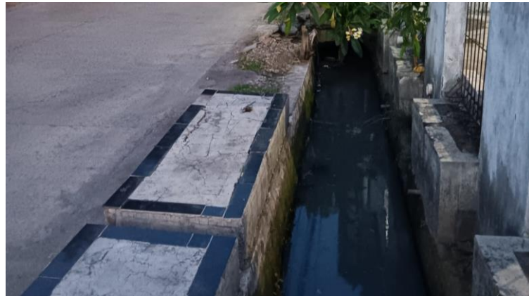
Kondisi Saluran SS02 ka
