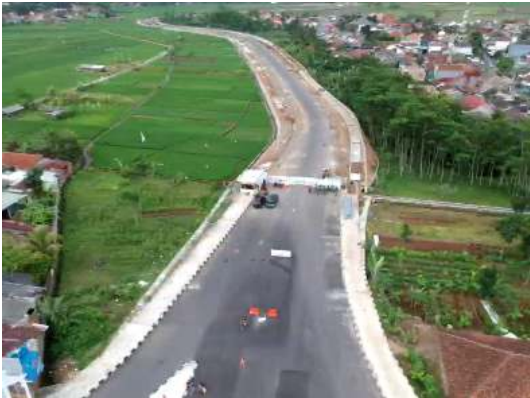
Gambar 1.3 Kondisi Jalan Hubung (Jalan Jenderal Sudirman dengan Jalan Gerilya)
