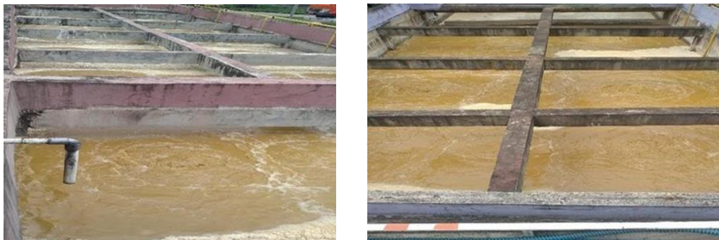
Gambar 2.13 Unit Aerasi I dan Aerasi II
