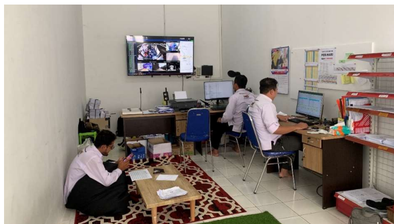
Gambar 5.18 Ruangans Pusat Kendali BRT Trans Banyumas
