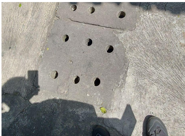
Gambar 3.46 Kondisi Drainase Kawasan Sumber: Mahendra, 2023
