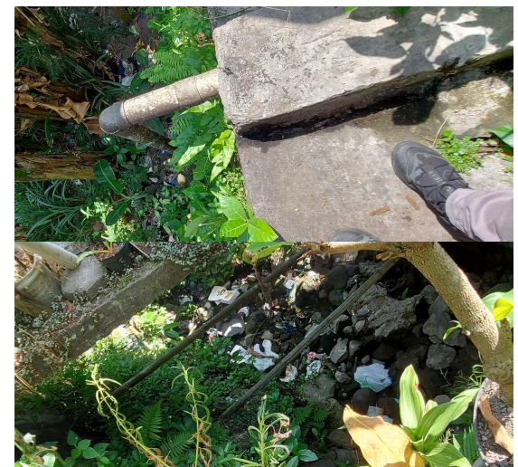
Gambar 3.48 Kondisi pembuangan limbah air Sumber: Mahendra, 2023
