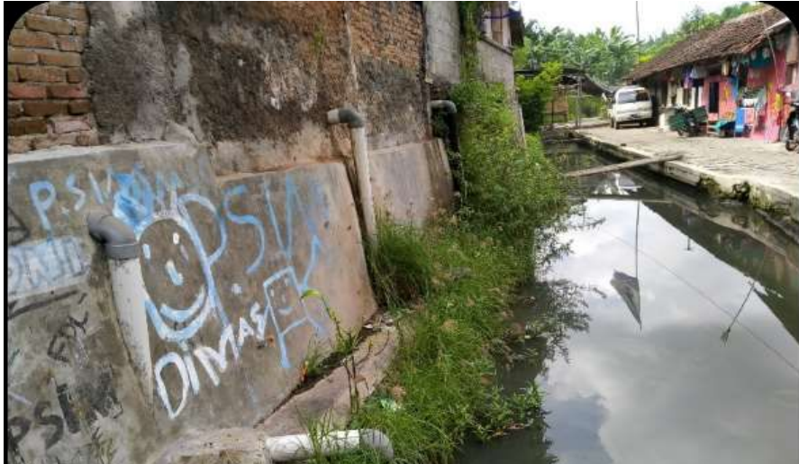
Gambar 2.7 Kondisi Permukiman Kumuh Sumber: Mahannani, Dinas Pekerjaan Umum, 2023
