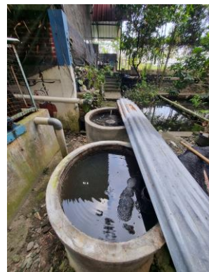
Pipa Effluent RBC
