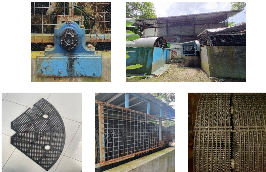
Gambar 4. 10 Kondisi Eksisting komponen unit RBC IPAL Ngudi Mulyo
