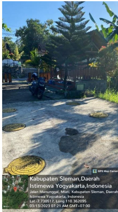
Gambar 5. 2 Kondisi Eksisting IPAL Bakti Warga
