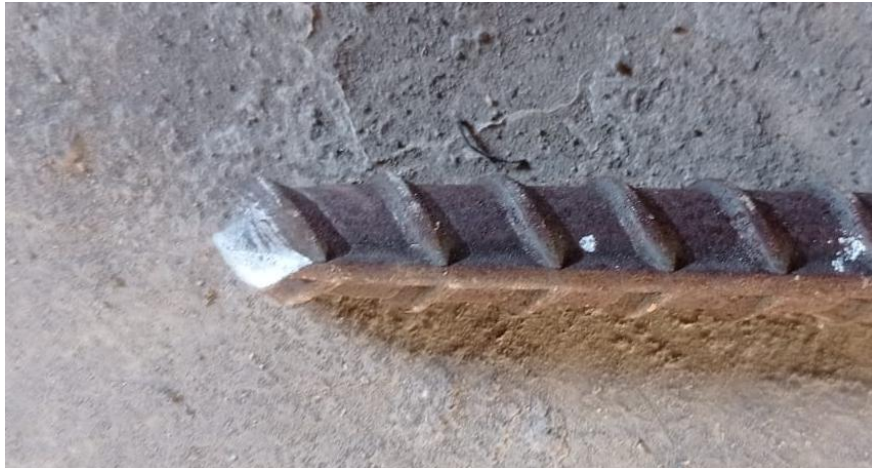
Gambar 5.3 Kersakan Baja Tulangan tanpa Sambungan
