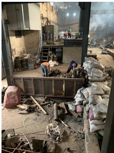
Gambar 4. 4 Mengambil besi bekas dari gudang
