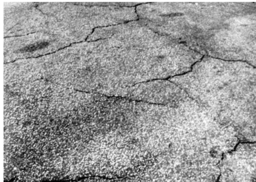
Gambar 3.2 Retak Kotak-Kotak ( Block Cracking )
