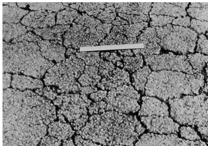
Gambar 3.1 Retak Kulit Buaya ( Alligator Cracking )
