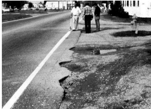
Gambar 3.3 Retak Samping Jalan ( Edge Cracking )
