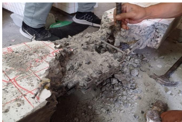
Gambar 5.20 Kondisi Tulangan Clamp Setelah Pembongkaran
