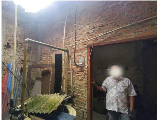
Gambar 5.52 Kondisi Dinding yang Berlubang dan Bergelombang
