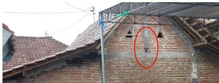
Gambar 5.55 Hasil Renovasi Struktur Ampig Tidak Sesuai Standar
