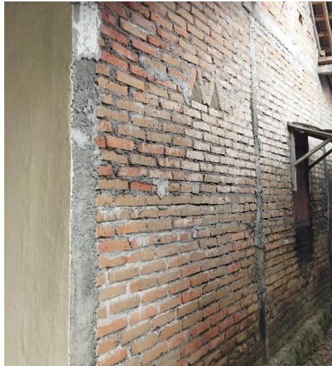
Gambar 5.54 Hasil Renovasi Struktur Kolom Tidak Sesuai Standar
