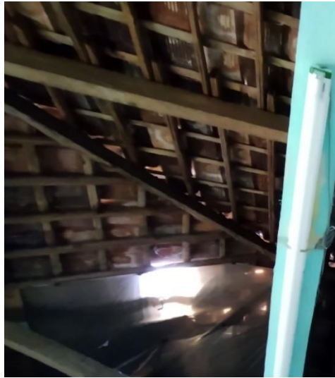
Gambar 5.56 Penutup Atap dibiarkan Rusak
