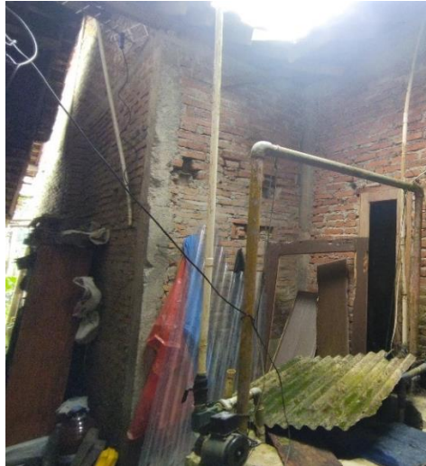
Gambar 5.53 Kondisi Kolom yang Keropos
