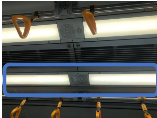
Gambar 5.37 Lampu di Kereta LRT Palembang
