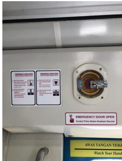
Gambar L-11.20 Petunjuk dan Emergency Door di Kereta LRT Palembang
