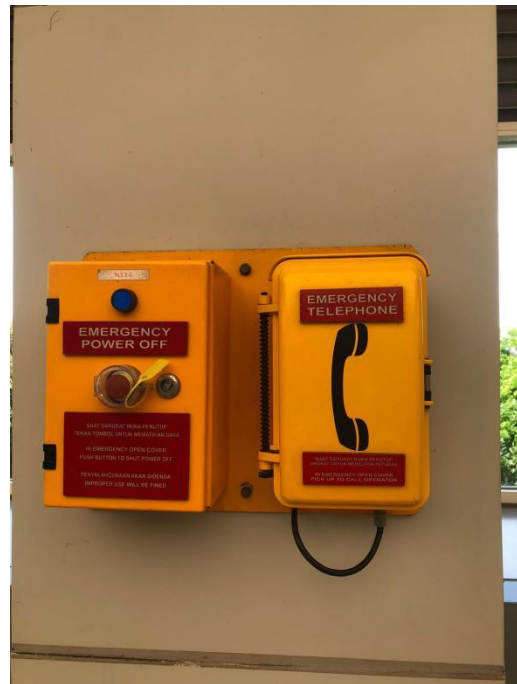
GambarL-11.10 Emergency telephone di Stasiun LRT Palembang
