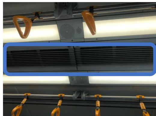
Gambar L-11.18 AC di Kereta LRT Palembang
