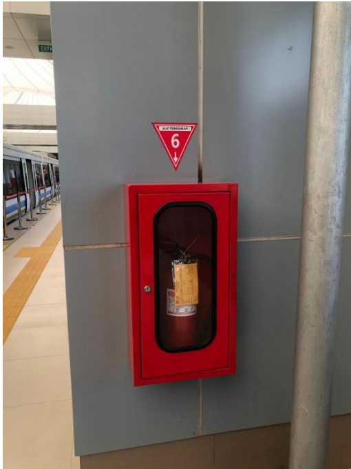
Gambar L-11.31 APAR di Stasiun LRT Palembang
