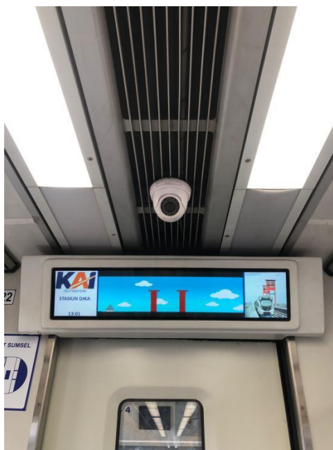
Gambar 5.45 CCTV di Kereta LRT Palembang
