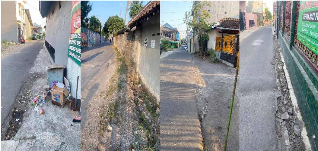
Gambar 1.1 Saluran Drainase Yang Bermasalah
