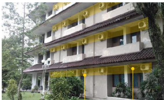
outdoor AC yang berada pada tiap ruang membuat bangunan terlihat kumuh kabel yang tidak tertata
