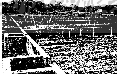
Gambar 3.2. SDB ( Sludge Drying Bed ) Pada Instalasi Pengolahan Air Limbah ( IPAL ) Domestik Sewon Bantul
