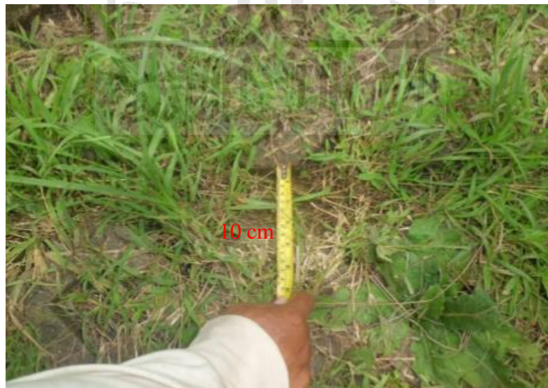
Gambar 1.7 Lebar Retakan/Rekahan Grass Block Pada Puncak Bendungan Selebar 10 cm
