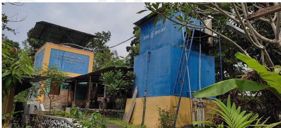
Gambar 4. 3 Instalasi Pengolahan Air Pamsimas
